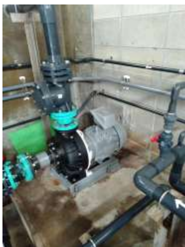
(海水送水システム) 逆洗ポンプ
