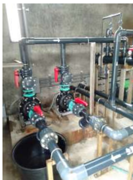
(海水送水システム) 取水ポンプ
